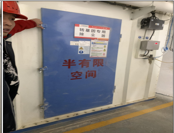
粉碎、筛分、打包工序除尘器
