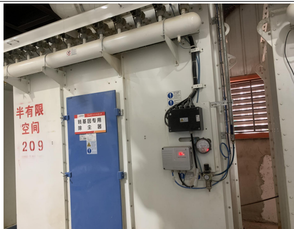
粉碎、筛分、打包工序除尘器
