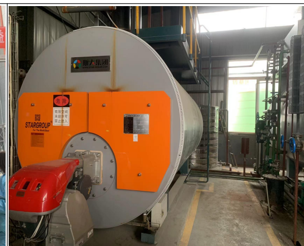
本次扩建增加锅炉 2t/h
