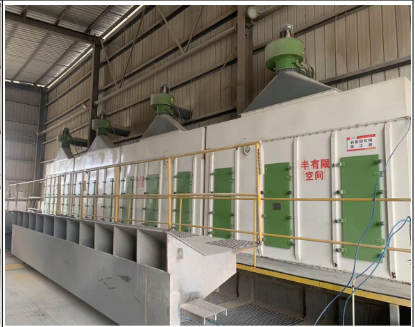
卸料工位布袋除尘器
