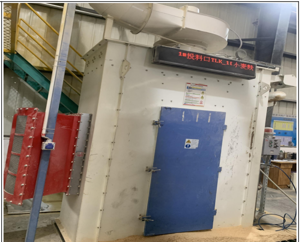
投料口布袋除尘器
